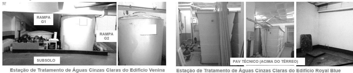
Figura 2. Estações de tratamento de águas cinzas claras dos edifícios Venina e Royal Blue, respectivamente.
